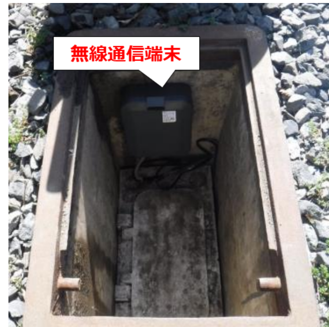
メーターボックス（プラスチック蓋） 側面に設置
