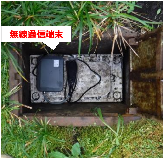
メーターボックス（鉄蓋） 防寒材上に設置
