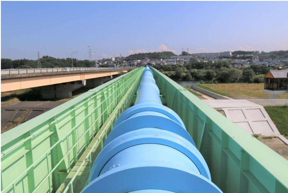
近代水道 100 選に選ばれたφ1,000mmの耐震配水管路（馬淵川西水管橋）
