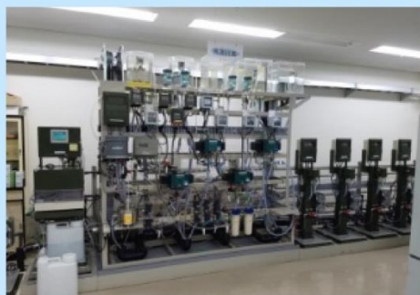
白山浄水場水質計器室
